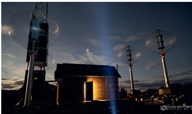
Figur 12.5 Telias basestasjonen ved Trollstigen har banebrytende, grønn teknologi. Foto: Eivind Bratteberg.
