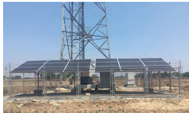
Figur 12.6 Solcellepanel på mobilstasjon i Myanmar. Foto: Telenor.
